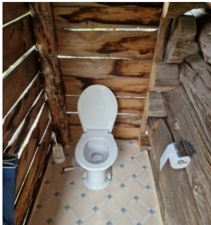
Das alte Plumpsklo hat nun eine WC-Schüssel mit Klappe, was hoffentlich nicht zu längeren Sitzungen führen wird!
